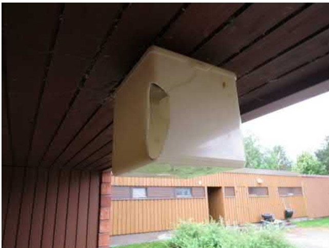
Kuva 93 Numerovalon kupu on rikki. PRH-sisäänkäynti, ulko-ovi.
