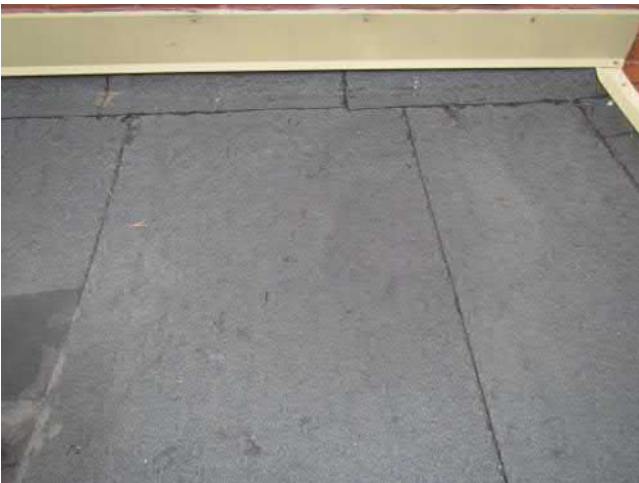
Kuva 44 Huotorakennuksen kateen pinnassa on pintahalkeamia.
