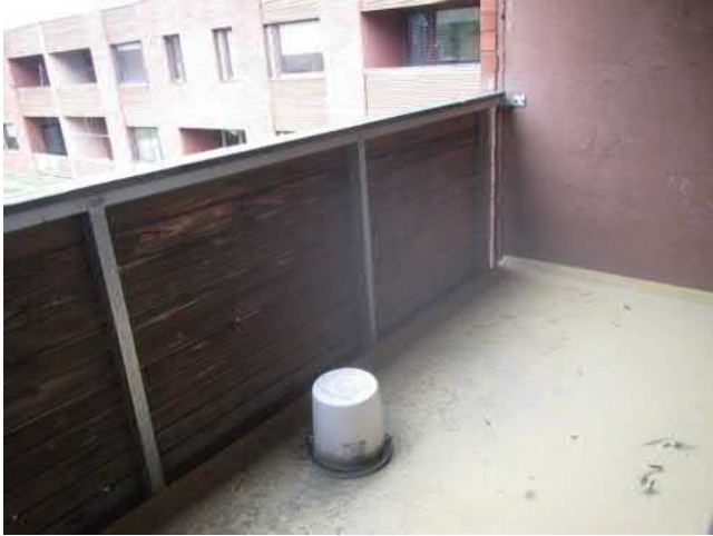
Kuva 35 Parvekelaatan maalipinta hilseilee.
