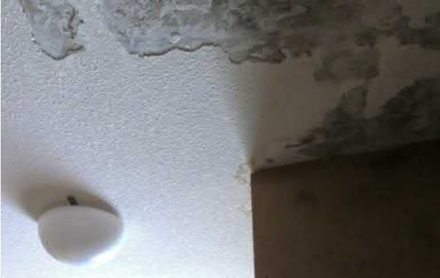
Kuva 51 1.krs kattorappaus on lohkeillut.
