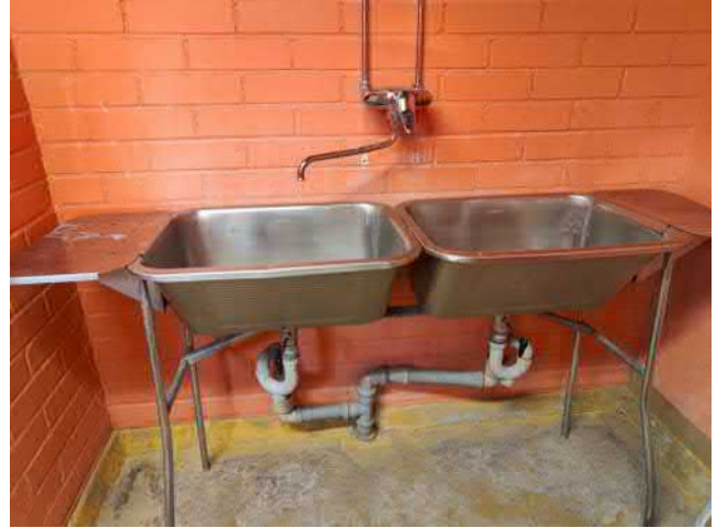
Kuva 64 Lattian maalipinta hilseilee.
