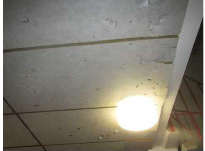
Kuva 56 Akustovillojen pinnoissa on vaurioita.
