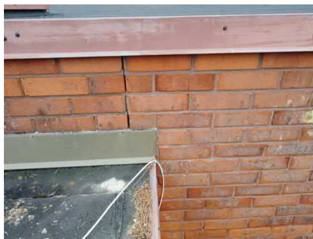
Kuva 21 Julkisivuverhous on ratkennut porrastavan rakennuksen kohdalla kattojen välisestä kohdasta.
