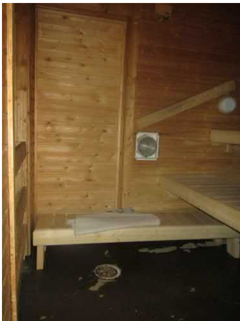
Kuva 61 Saunan lattian maalipinta hilseilee.
