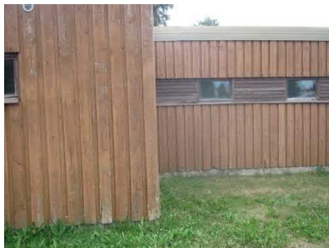
Kuva 25 Maalipinta on huonokuntoinen.
