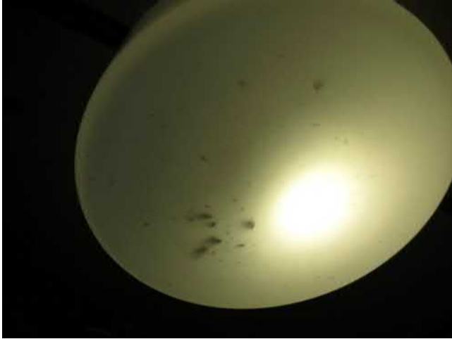
Kuva 91 Porrashuoneen valaisin, kärpäsiä
