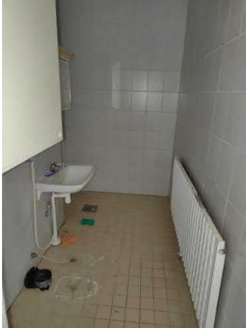
Kuva 59 C rapun pesuhuone josta on poistettu vesikalusteita.
