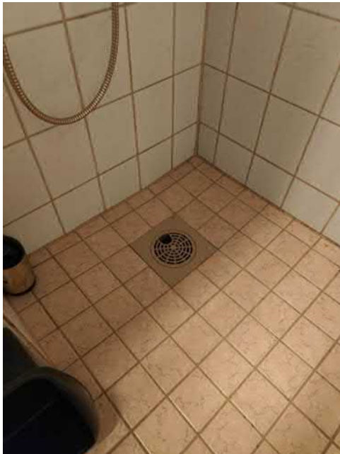
Kuva 73 Lattiakaivojen kannet muovia.
