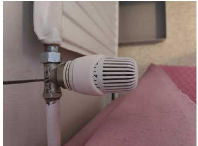
Kuva 66 Termostaattiventtiilit uusittu jossain vaiheessa, ajankohta ei ole tiedossamme. Aistinvaraisesti arvioiden kuitenkin käyttöikänsä loppupuolella.
