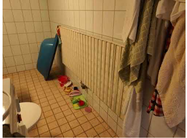
Kuva 68 Pesuhuoneissa isot rätipatterit.
