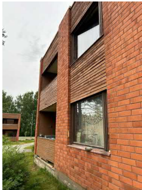
Kuva 19 Ikkunoiden välissä oleva paneeliverhous on huonokuntoinen.
