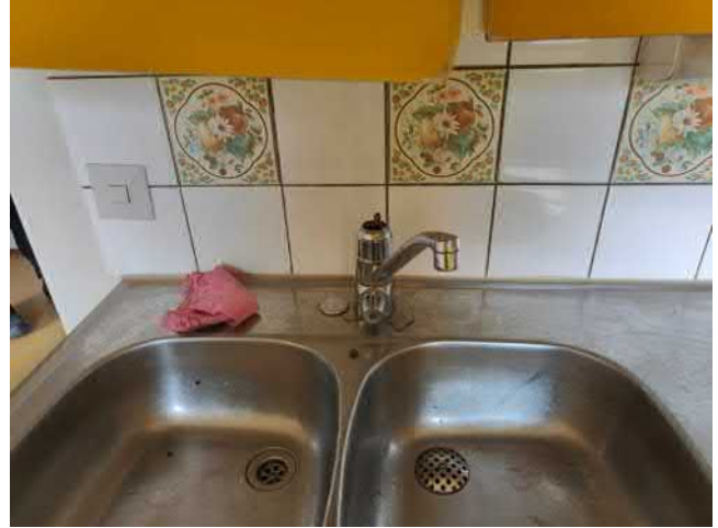
Kuva 76 Vesi- ja viemärikalusteille tehty ilkivaltaa.
