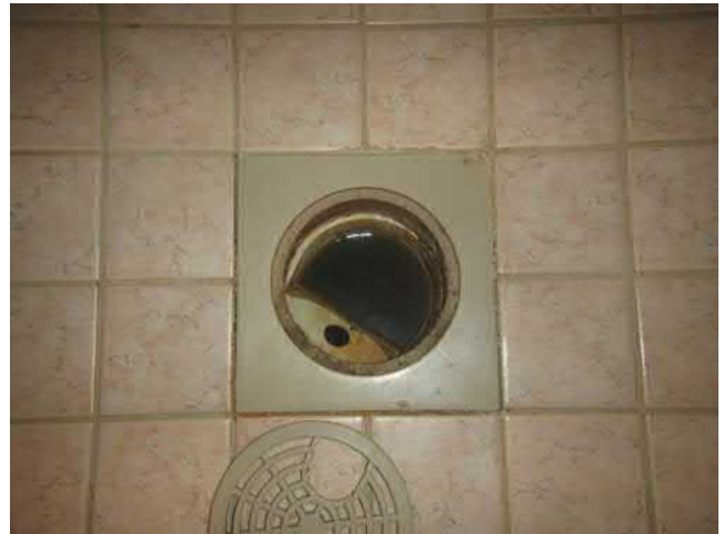
Kuva 58 Lattiakaivo, josta puuttuu kaivon ns rassaustulppa.
