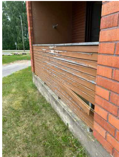
Kuva 34 Parvekkeiden kaiteen paneeliverhous on huonokuntoinen. TURVALLISUUSRISKI
