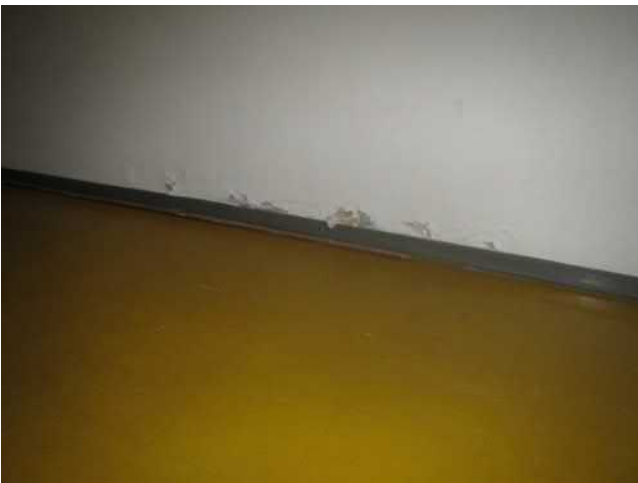
Kuva 53 B rapun väliseinän kosteusjälki.
