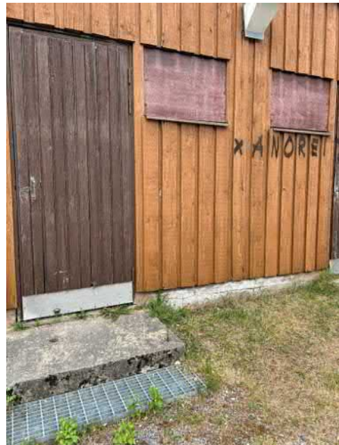
Kuva 8 Yhteistilarakennuksen sokkelissa on kosteudesta aiheutunutta värjäytymää ja halkeilua. Sokkeli on huonokuntoinen.
