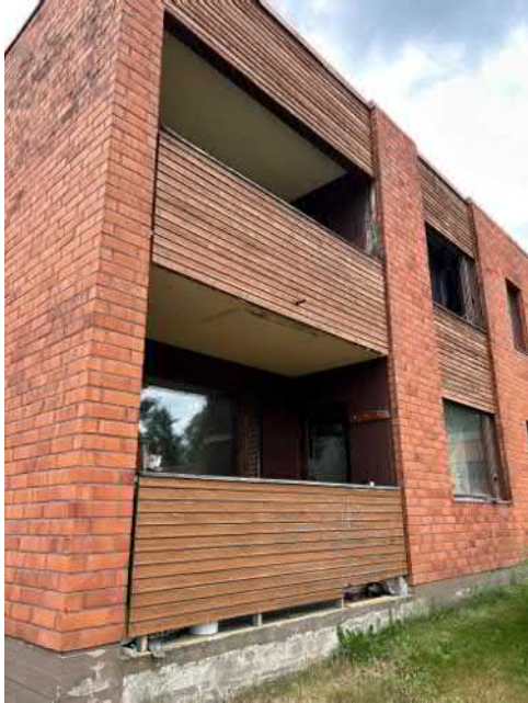
Kuva 5 Sokkelissa on pintavaurioita.
