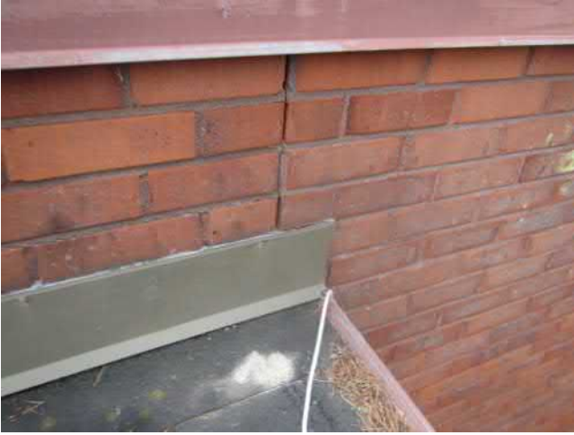
Kuva 42 Suojapellin ja tiiliseinän tiivistysmassa on huonokuontoinen.
