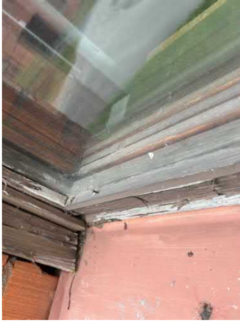
Kuva 28 Ikkunoiden ulkopuolen rakenneliittymissä on rakoja, joista vesi voi päästä taustarakenteisiin.
