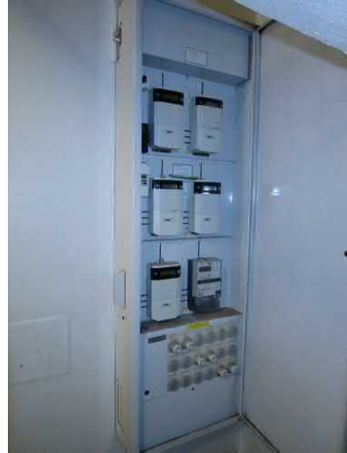
Kuva 84 Mittarikeskus, porrashuone. Asuntojen nousut ja mittaukset yksivaiheisia 1x25A.
