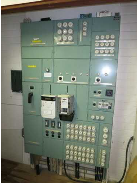
Kuva 83 Sähköpääkeskus. alkuperäinen vuodelta 1976
