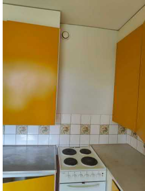
Kuva 82 Poistoventtiilit asunnoissa ns. likaisissa tiloissa.
