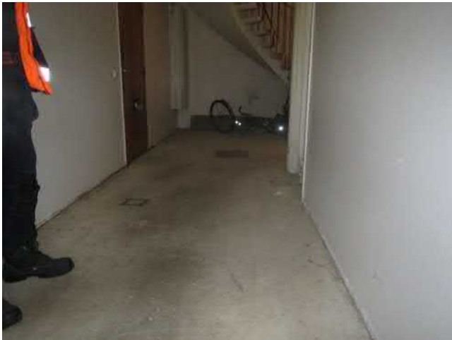
Kuva 11 B rapoun porraskäytässä ei ole lattiapinnoitetta
