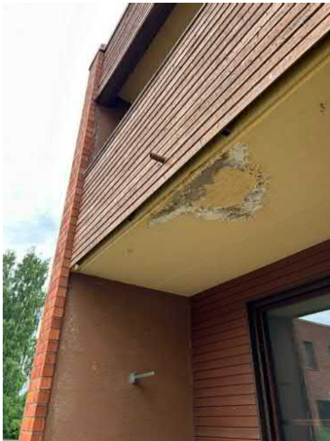
Kuva 37 Joidenkin parvekelaattojen alapuolella on kosteuden aiheuttamia jälkiä.
