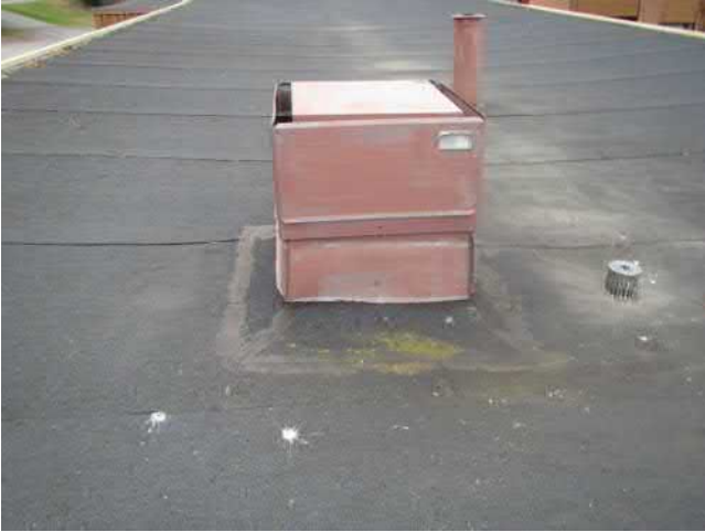
Kuva 77 Yleiskuva huippuimurit. Tekninen käyttöikä ylittynyt.
