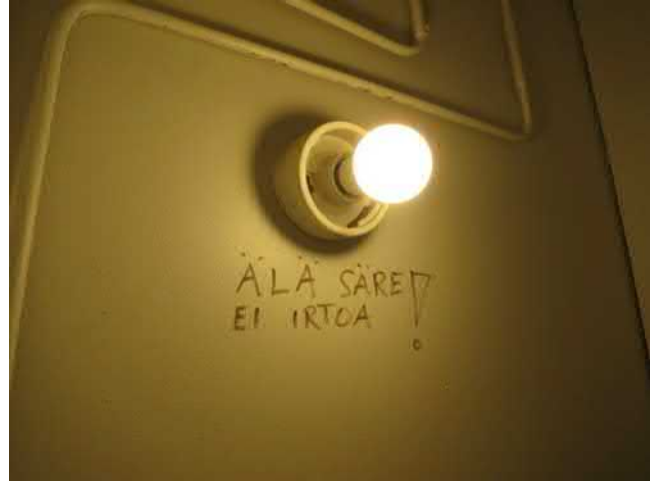
Kuva 92 Yhteistiloja valaisin, kupu puuttuu.
