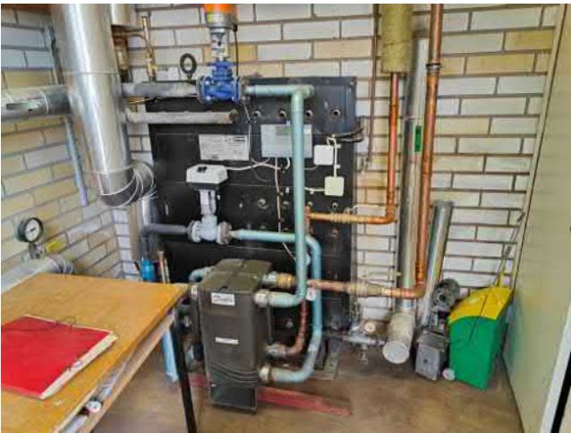
Kuva 65 Yleiskuva lämmönjakokeskus. Siirrin ja osa venttiileistä uusittu. Eristeissä puutteita.
