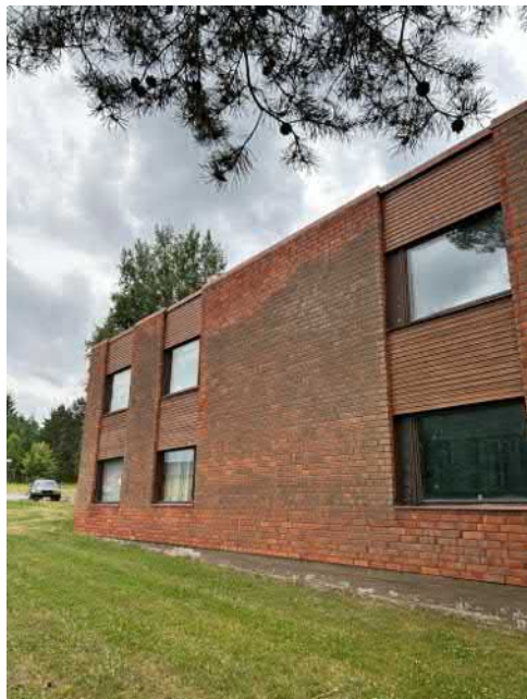
Kuva 22 Ulkoseinissä kasvaa jäkälää.
