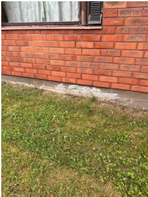
Kuva 7 Sokkelissa on pintavaurioita.
