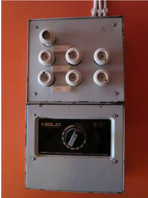
Kuva 96 Vanhahko sähkökiukaan ohjauskeskus. Ei lukittu, eikä viikkokelloa.
