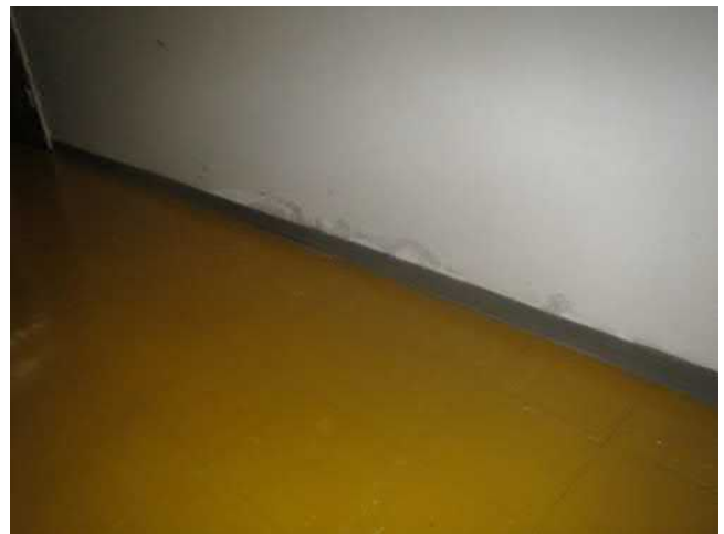
Kuva 50 A rapun väliseinän kosteusjälki.
