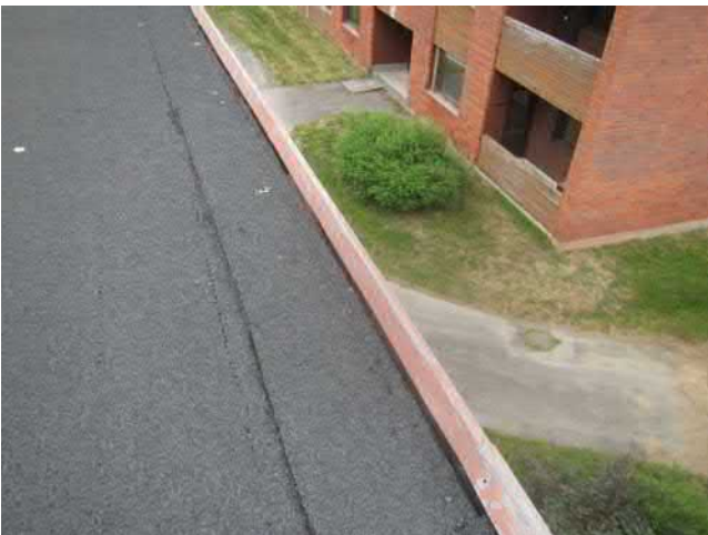
Kuva 40 Pintakermin reuna ei ole suojapellin alapuolella eli suojapellin mitoitus tai kiinnitys ei ole riittävä.
