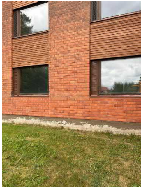
Kuva 18 Ulkoverhuksen alaosissa ei ole tuuletusaukkoja.
