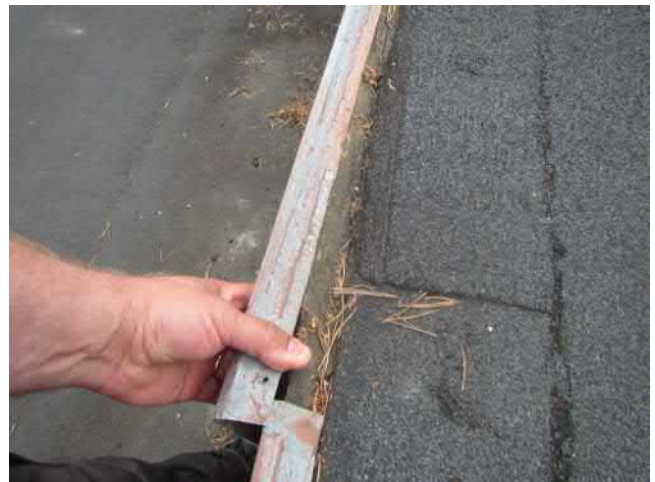
Kuva 41 Räystäspeltti ei anna riittävää suojaa.
