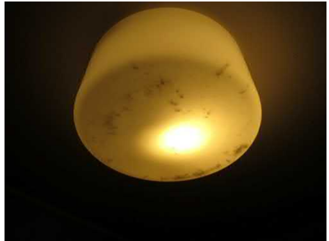
Kuva 90 Yhteistilojen valaisin, kellastuntu ja täynnä kärpäsiä.
