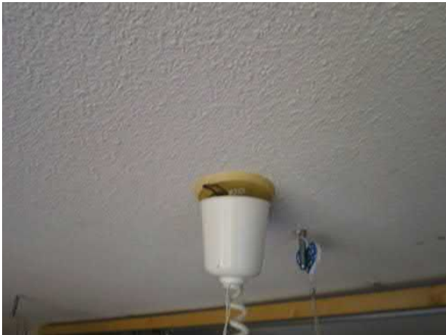
Kuva 89 Asunnon kattovalaisinpiste, "sokeripala"-liittimet.
