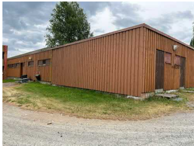
Kuva 23 Huoltorakennuksen ulkoverhous on huonokuntoinen.
