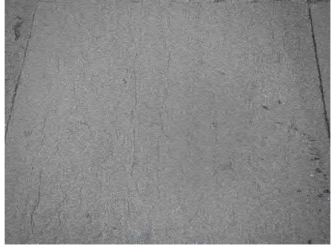
Kuva 43 Katteen pinnassa on pintahalkeamia.
