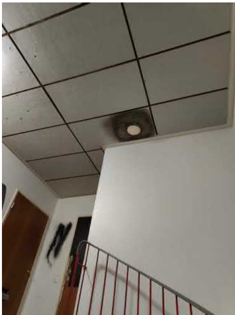
Kuva 79 Porrashuoneen poistoventtiili. Kosteutta kertynyt runsaasti.
