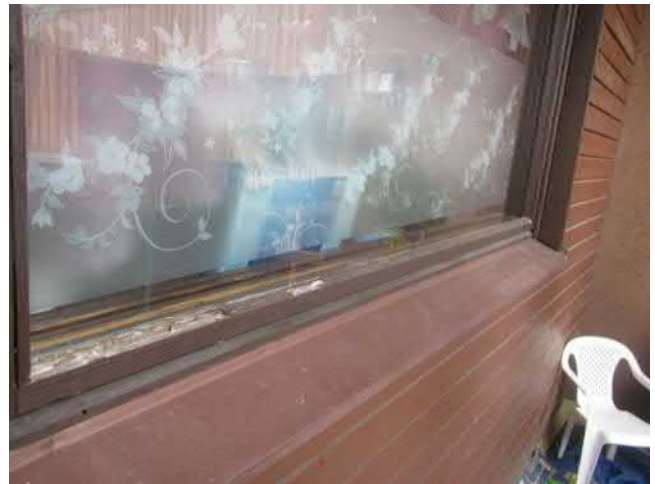
Kuva 27 Ikkunoiden ulkopuolen kunto on heikko.
