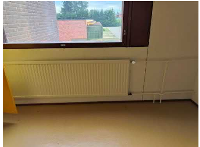
Kuva 27 Yleiskuva huoneistojen patterit. Patterit ja patterirungot alkuperäisiä. Patteriventtiilit ja termostaatit uusittu jossain vaiheessa, ajankohta ei ole tiedossamme. Aistinvaraisesti arvioiden kuitenkin käyttöikänsä loppupuolella.
