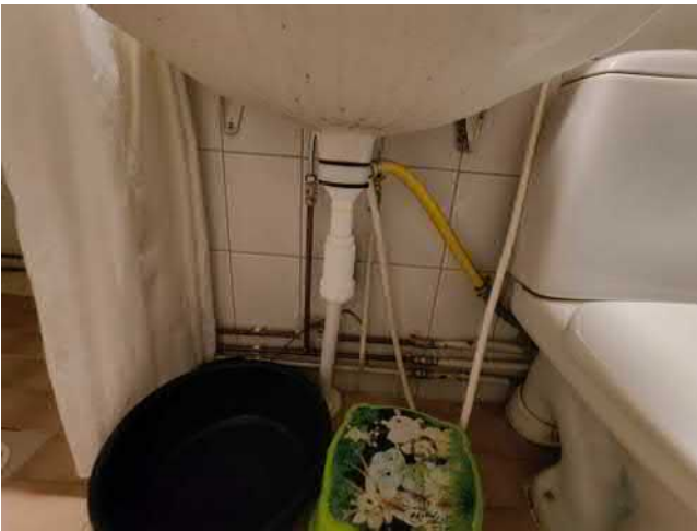
Kuva 28 Putkimateriaalit havaintojen mukaan kuparia. Kalustesulkuja uusittu ilmeisestä tarpeen mukaan.
