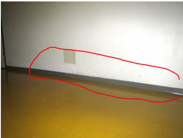
Kuva 21 Seinän ja välipohjan kosteusalue noin.
