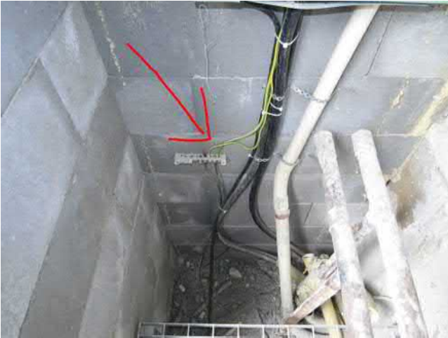
Kuva 45 Maadoitusjohtimet merkkäämättä. Tekninen tila
