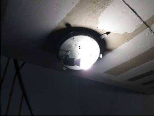
Kuva 49 Porrashuoneen valaisin, huonossa kunnossa. Kupu puuttuu.
