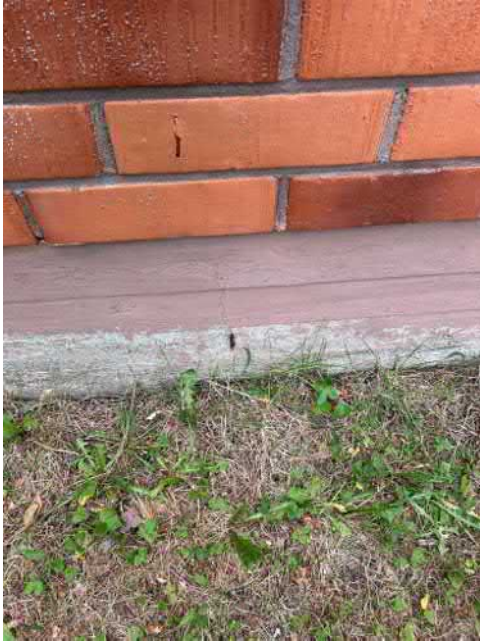
Kuva 3 Kosteudesta johtuvaa pinnan irtoamista sokkelissa. Raudoite näkyvissä. Sokkelissa halkeama.
