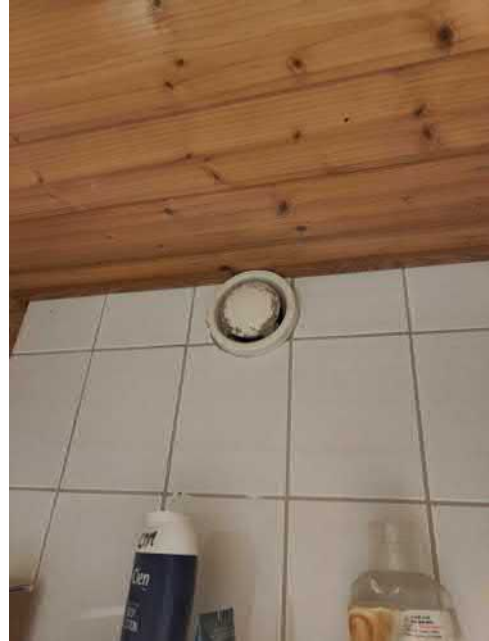
Kuva 36 Poistoventtiileissä runsaasti pölykertymää.
