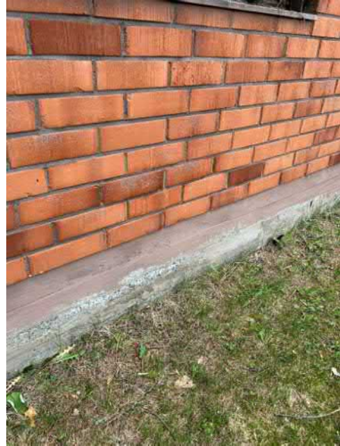
Kuva 4 Kosteudesta johtuvaa pinnan irtoamista sokkelissa.
