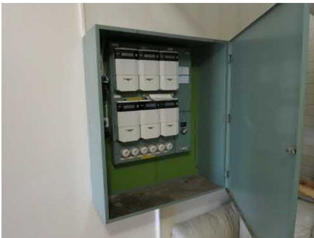
Kuva 43 Mittarikeskus, porrashuone. Alkuperäinen vuodelta 1977 Asuntojen nousut ja mittaukset yksivaiheisia 1x25A.
