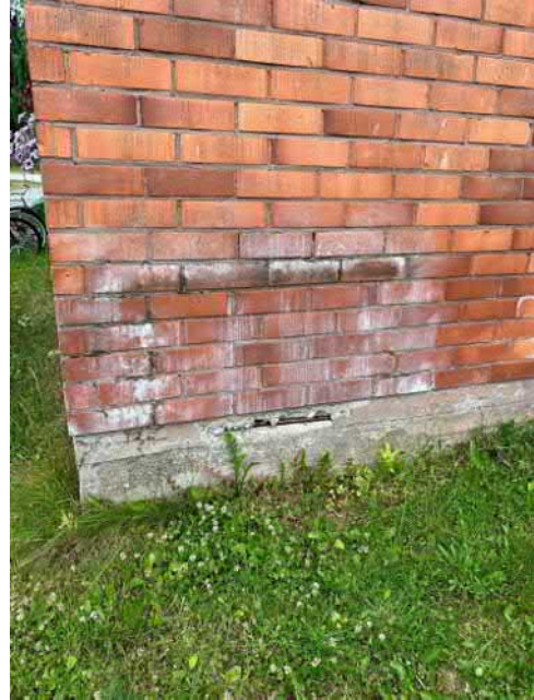
Kuva 10 Ulkoseinää vasten on ollut jokin, joka on aiheuttanut todennäköisesti sokkeliin ja ulkoseinään vaurioita.
