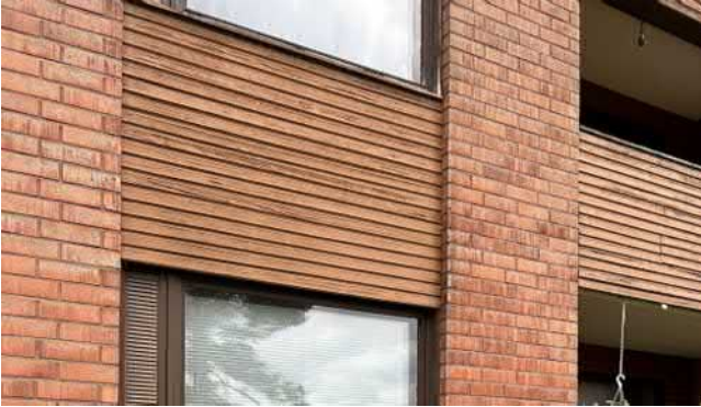
Kuva 9 Paneeliverhous on huonokuntoinen.
