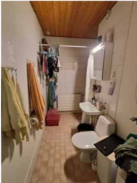
Kuva 37 Poistoventtiilit asunnoissa ns. likaisissa tiloissa.
