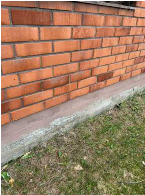
Kuva 7 Ulkoseinämuurauksen alaosissa ei ole tuuletusreikiä.
