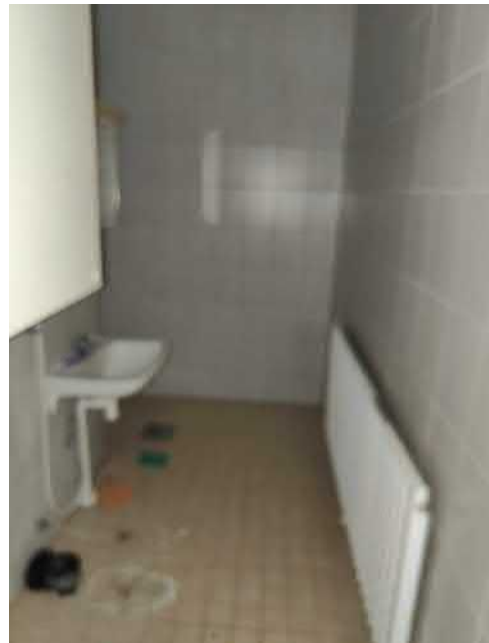
Kuva 33 Vesi- ja viemärikalusteille tehty ilkkivaltaa.
