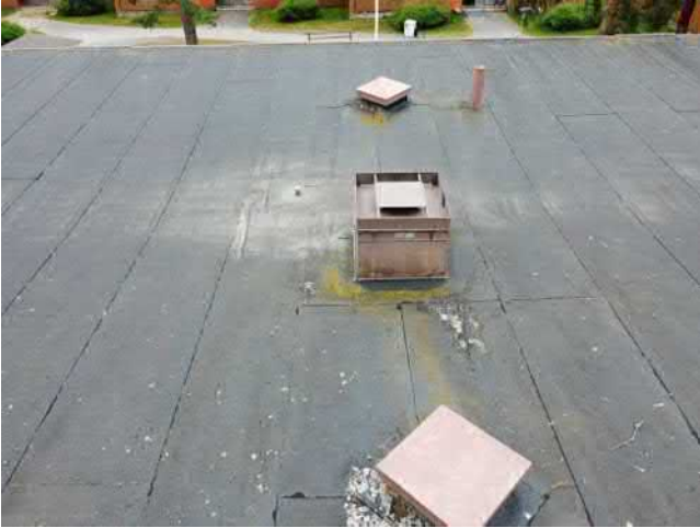
Kuva 35 Yleiskuva huippuimurit. Tekninen käyttöikä ylittynyt.
