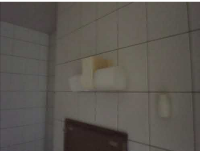
Kuva 51 Kylpyhuoneen valaisin, alkuperäinen vuodelta 1997
