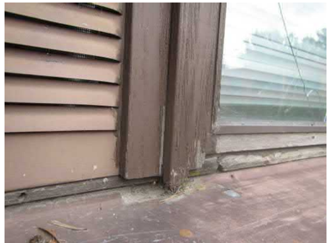
Kuva 13 Vesipeltien ja ikkunoiden liittymistä vesi voi päästä rakenteiden taustalle.
