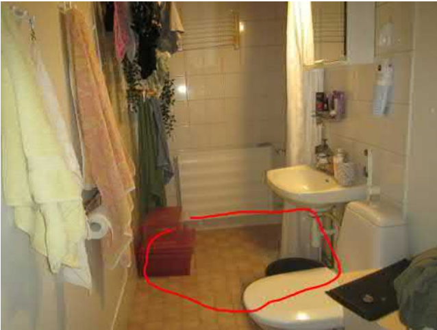
Kuva 24 1. krs huoneiston pesuhuoneen kosteusalue noin.
