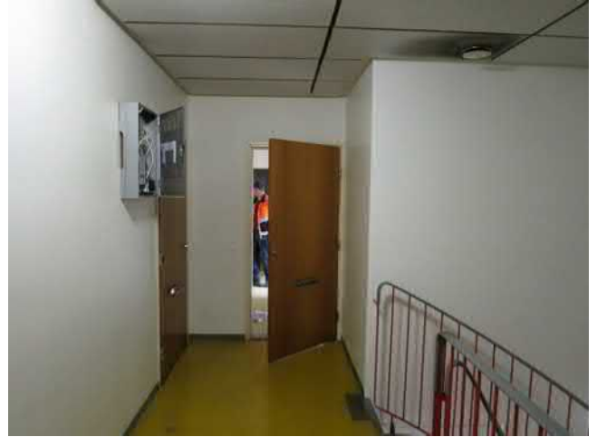
Kuva 40 Porrashuoneen poistoventtiili. Kosteutta kertynyt runsaasti.
