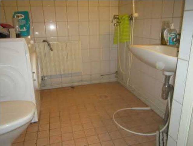
Kuva 34 Yleiskuva asuntojen vesi- ja viemärikalusteista ja kytkentäpukista.
