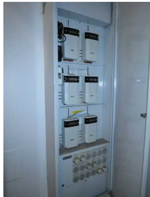
Kuva 44 Mittarikeskus, porrashuone. Asuntojen nousut ja mittaukset yksivaiheisia 1x25A.
