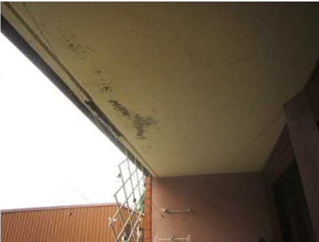
Kuva 14 Parvekkelaatana alapuolella maalipinta hilseilee.
